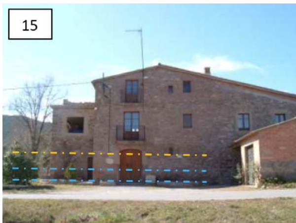
Figura 16. Marca de la inundació del 12/10/1907 situada a Sant Joan de Vilatorrada - Façana edifici (Font: ACA, foto del 06/03/2012)
