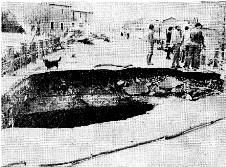
Figura 2. Esvoranc al paviment de la carretera entre la Canya i Camprodon a l'alçada de Clocalou (Font: Arxiu Municipal de Girona. Sitios de Gerona)
