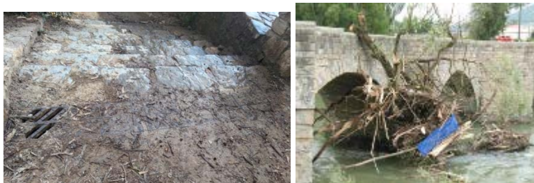
Figura 4. Embornal taponat per sorra i restes i pont taponat per restes que ha arrossegat el riu
