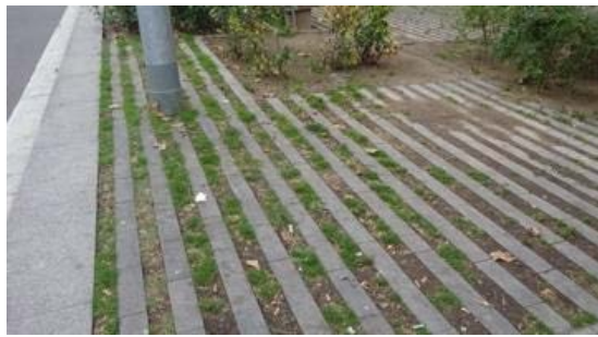
Paviment drenant al Passeig Sant Joan de Barcelona (Floodup)
