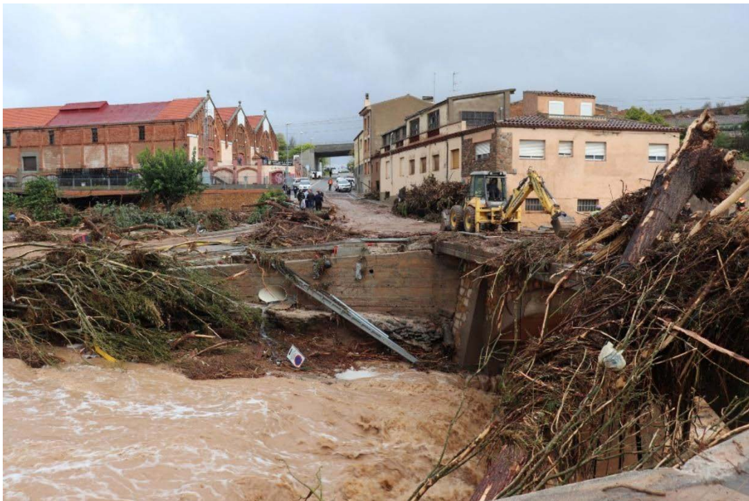
Figura 2. Fotografia de l'impacte de la riuada a l'Espluga de Francolí (Font: A. Roca).
